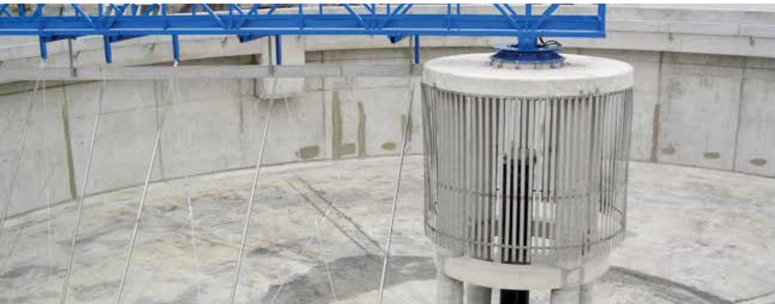
Biologiczna Oczyszczalnia Ścieków w Grójcu.
